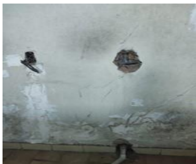
Figura 8. Bolor da alvenaria (acervo pessoal)
