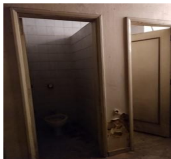
Figura 11. Descascamento da tinta da alvenaria (acervo pessoal)
