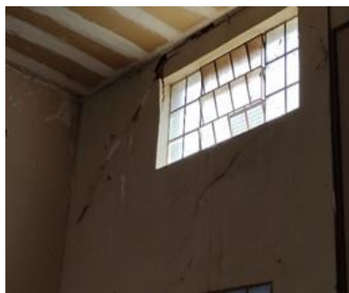
Figura 12. Trinca possivelmente causada pela falta de verga e contra-verga (acervo pessoal)
